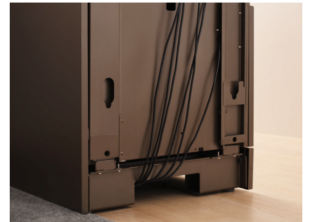
2 大容量垂直配線ライザーでコード類をすっきりと処理
